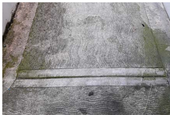
Figura 18 - Pavimentazione di una rampa per disabili in calcestruzzo con texture ondolata ottenuta passando un pettine o spatola dentata sulla superficie ancora fresca
